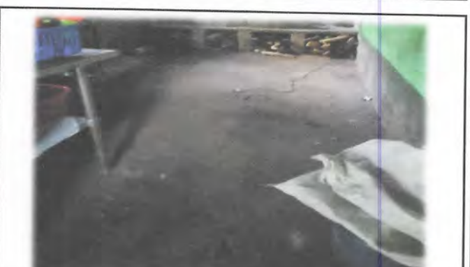
Foto 4: Es necesario el cambio e instalación de piso antideslizante en el módulo de cocina.
