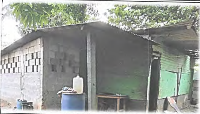
Foto7: Es necesario el cambio e instalación de lamina troquelada aluzinc calibre 26. incluye tornillos
