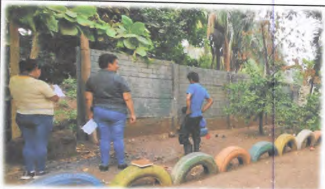
Foto 10: Es necesario el cambio e instalación de muro perimetral prefabricado a muro de block, incluye columnas y soleras.
