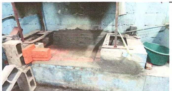
Foto 15: Mantenimiento a estufa rural. Cocina
