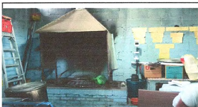
Foto 15: Mantenimiento a estufa rural . Cocina
