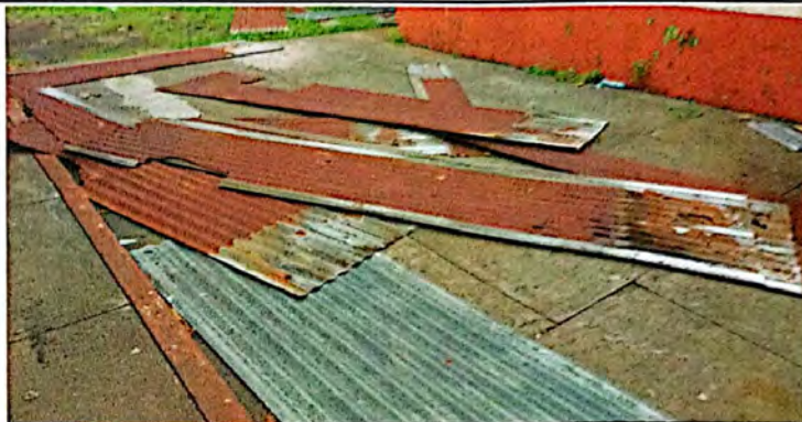
Foto 8: Lamina desmontada del 2do módulo de aulas más dirección, se puede observar su avanzado estado de deterioro.
