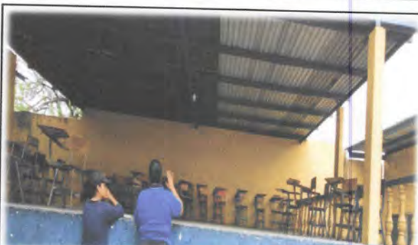
Foto 10: Es necesario el cambio e instalación de estructura de metal, incluye lijado y pintura anticorrosiva en el módulo del escenario.
