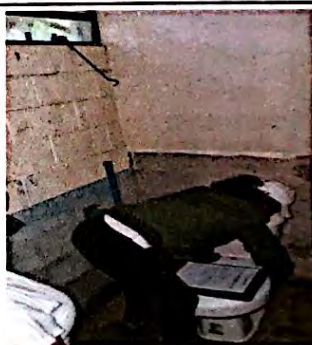
Foto 4: Evaluadora de campo inspecciona las instalaciones de los accesorios en los inodoros, en el modulo de servicios sanitarios.
