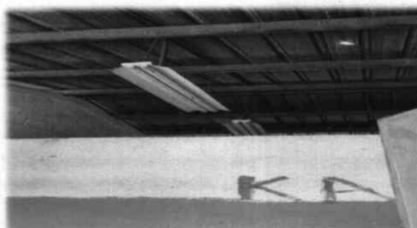
Foto 12: Las actuales laminas, se encuentran en bastante deterioro por el oxido y agujeros. Interior.
