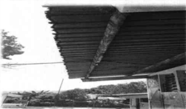
Foto 10: Las actuales laminas, se encuentran en bastante deterioro por el oxido y agujeros. Exterior.
