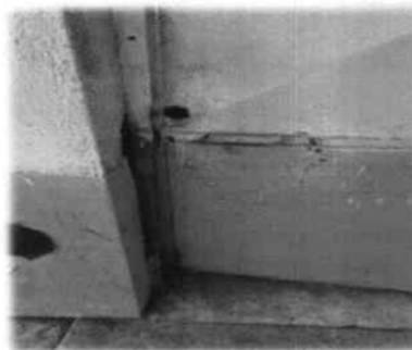
Foto 6: Se sustituyen las puertas principales de los servicios sanitarios, ya que se encuentran en pesimas condiciones en el deterioro del material y chapas.
