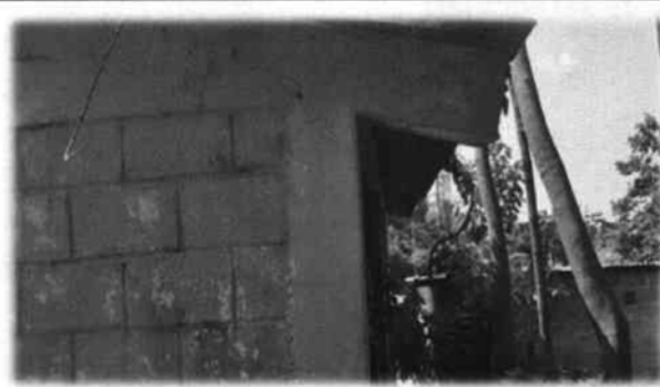
Foto 8: Se encuentro poca distancia de alero de lamina, lo que permite que la estructura de jois de metal se deteriore por condiciones climaticas.
