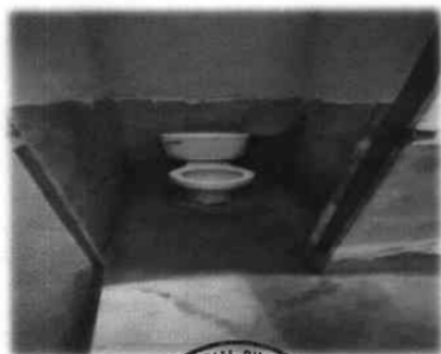
Foto 5: Se realizara mantenimiento en las puertas de las divisiones de los inodoros porque se encontraron deterioradas.
