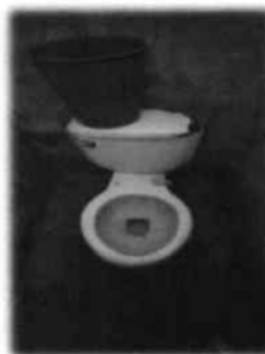
Foto 4: Se cambiarán eh instalarán 4 unidades de inodoros, ya que se encuentran quebrados y deteriorados.
