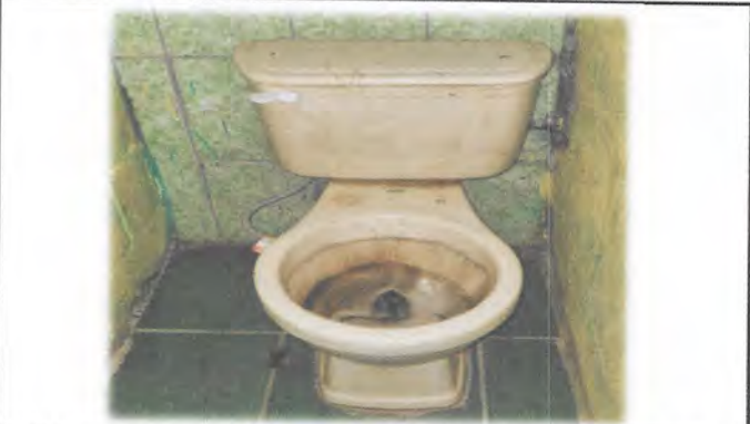
Foto 3: Una de las necesidades que se evaluarán en el módulo de baños es el cambio e instalación de inodoros.
