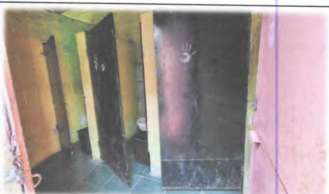
Foto 4: Se evaluó la necesidad de reparar y darle mantenimiento a las puertas del módulo de baños
