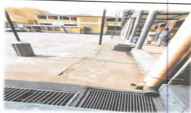
Foto 12: Es necesaria la reparación y mantenimiento de drenaje pluvial.
