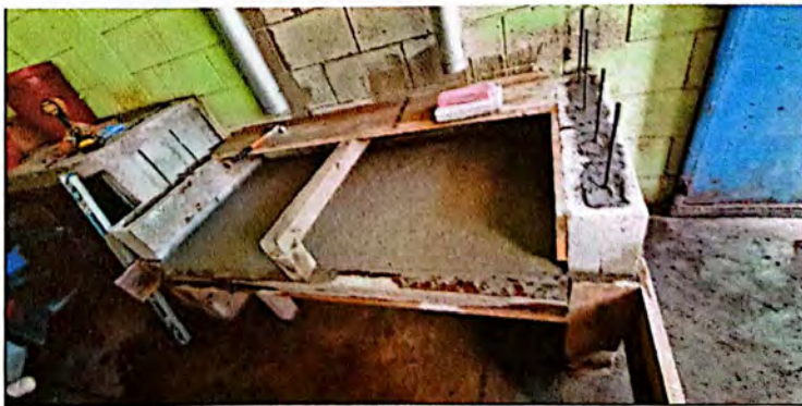
Foto 6: Avance en el modulo de cocina, estufa rural de leña.
