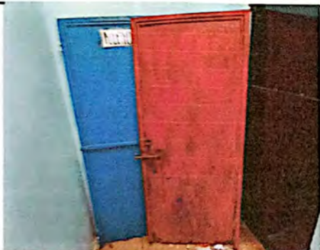
Foto 9: Se observa el severo deterioro en la parte inferior de las puertas retiradas durante su proceso de reparación en el módulo de servicios sanitarios.
