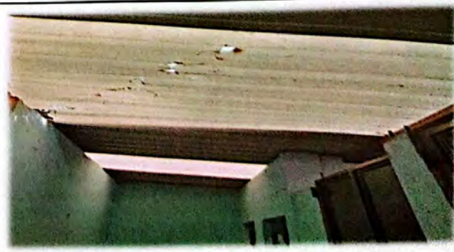
Foto 6: Lamina quebras en el área del servicio sanitario de niños, niñas y docentes.
