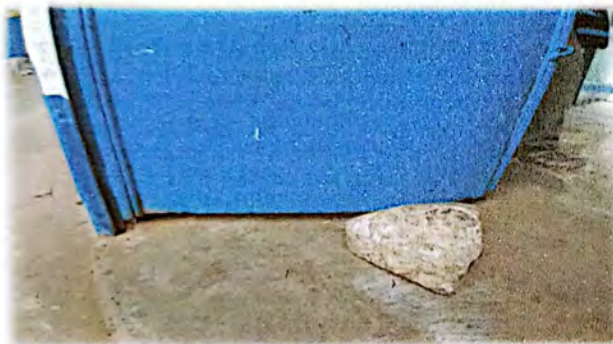
Foto 9: Sustitución del segundo portón, el material existente del mismo presenta deterioro en toda el area del mismo.
