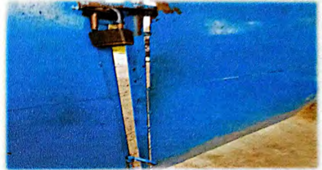
Foto 8: Sustitución de portón principal, actualmente el portón de ingreso presenta ineficiencia en su función, ha tenido un mal proceso de reparación y por ende presenta mas problemas.
