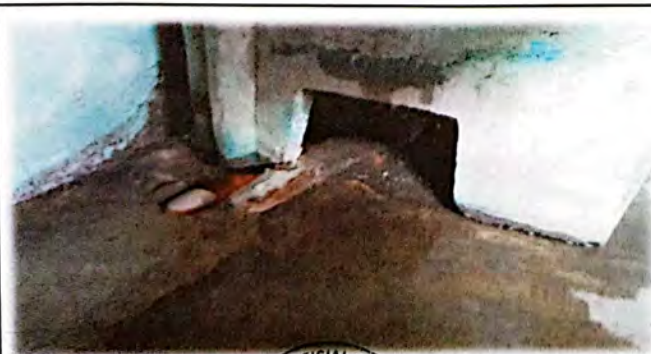
Foto 5: Drenaje en malas condiciones de la pila que se encuentra dentro del área de Cocina.
