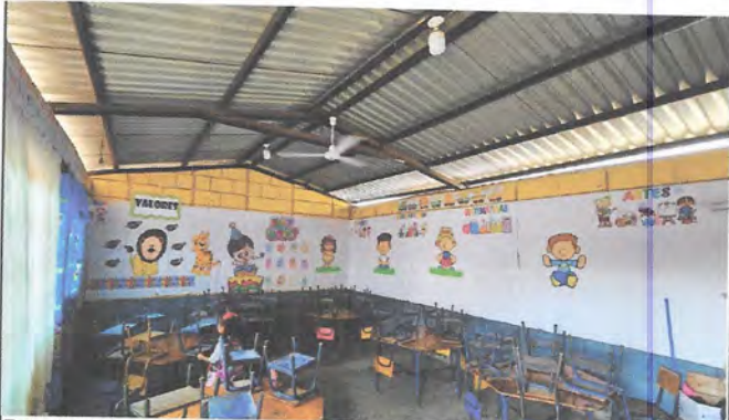
Foto 12: Condiciones generales de las aulas de la escuela durante la visita técnica.
