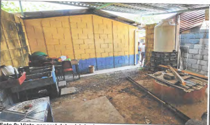
Foto 9: Vista general del módulo de cocina en donde el piso presenta deterioro considerable.
