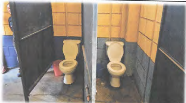
Foto 3: Es necesario el mejoramiento de modulo de servicios sanitarios (incluye reparación, cambio de tubería y artefactos).
