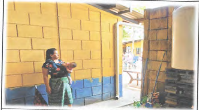
Foto 7: Se detectó la necesidad de trabajos de herrería, reparación y mantenimiento puerta principal, puerta tipo reja y balcones
