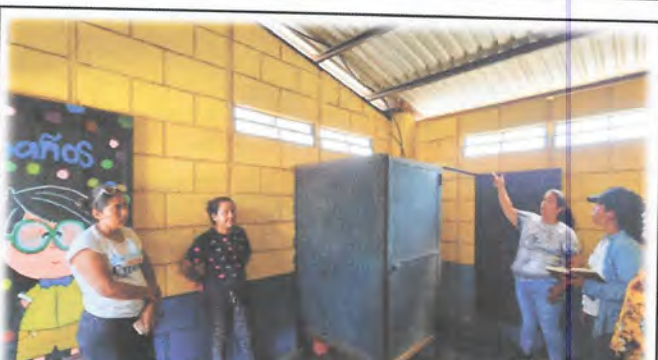
Foto 4: Son necesarios trabajos de herrería, reparación y mantenimiento puerta principal, puerta tipo reja , balcones y divisiones de cubiculos de servicios sanitarios.
