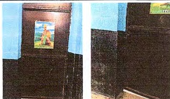
Foto 10: Sustrucción de puerta, 6to. Primaria sección A y B.
