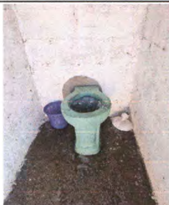
Foto 3: SERVICIOS SANITARIOS Y SUS ACCESORIOS
