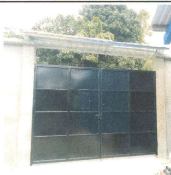
Foto 2: Puertas de Metal
