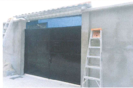
Foto 2: Puertas de Metal
