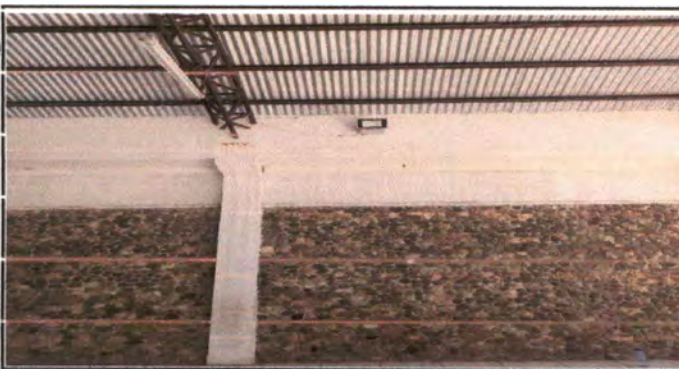
Foto 5. Lámparas LED previo a sustitución.
