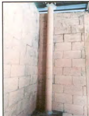
Foto 14: Estado final de chimenea de concreto.
