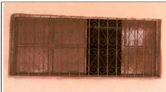
Foto 3: Estado final de ventanas y balcones
