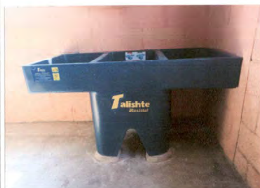
Foto 15: Estado final de pila plástica de dos lavaderos
