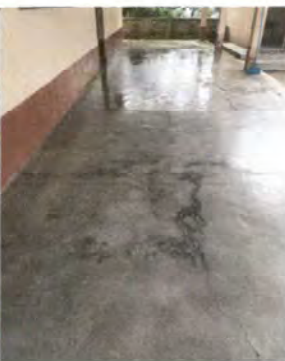
Foto 5: Estado inicial de piso de torta de concreto
