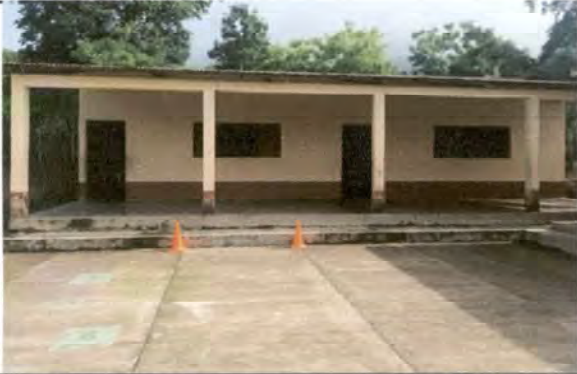
Foto 7: Estado inicial de pintura en muros exteriores e interiores.
