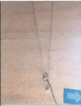
Foto 12: Estado inicial del cableado eléctrico.
