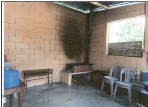
Foto 14: Estado inicial de la chimenea de la cocina escolar.
