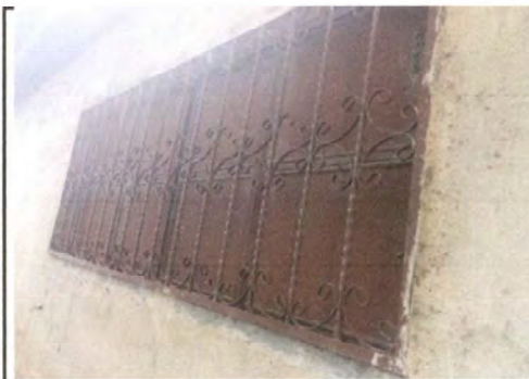
Foto 4: Estado inicial de balcón de metal
