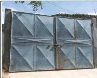
Foto 2: Estado inicial de portón de metal
