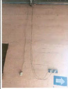
Foto 10: Estado inicial de los apagadores y tomacorrientes en las aulas
