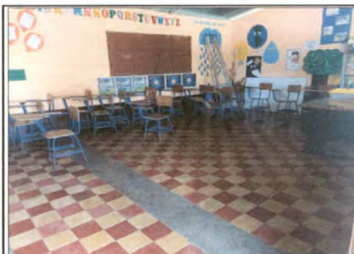
Foto 6: Estado inicial de piso en las aulas
