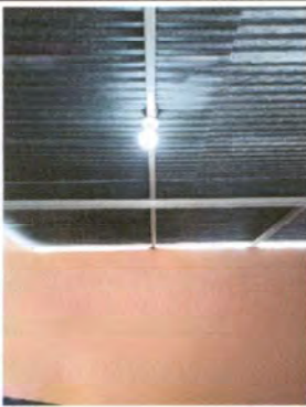
Foto 9: Estado inicial de focos y plafoneras en las aulas
