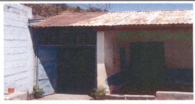
Foto 18: Sustrucción de lámina
