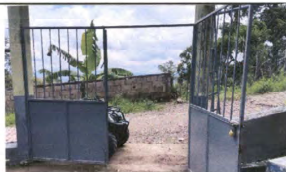
Foto 4: Mantenimiento del porton, lijado y pintura se requiere y sustitución de el pasador.
