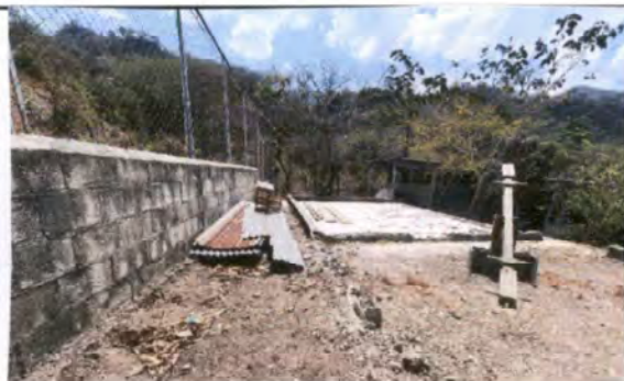
Foto 3: losa de concreto en mal estado, la cual se utiliza de área recreativa.
