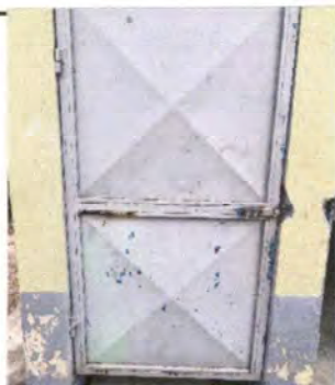
Foto 3: Puertas de los sanitarios dañadas las cuales requieren de sustitución.
