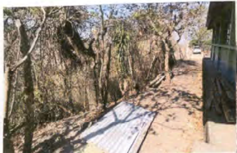
Foto 1: cerco provicional en mal estado.
