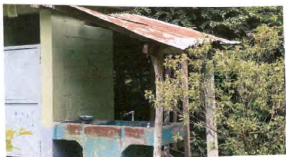
Foto 1: Techo de pila con base de madera y lámina en mal estado sostenida con alambre de amarre de forma provisional
