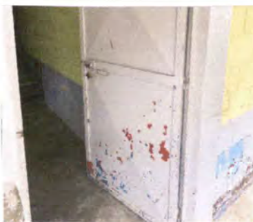
Foto 2: Puertas de metal de las aulas las cuales requieren de pintura y reparación de algunas partes.
