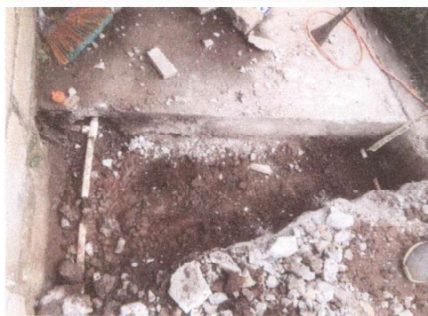
Foto 2: Red de agua potable
