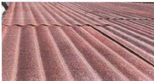
Foto1: Techo dañado de aula.
