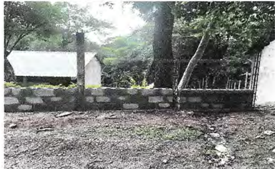
FOTO 2: MAYA Y COLUMNAS EN MAL ESTADO
