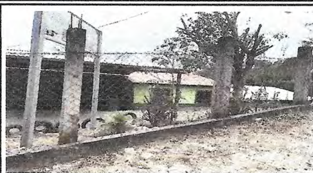
FOTO 2: MALLA Y COLUMNAS EN MAL ESTADO
