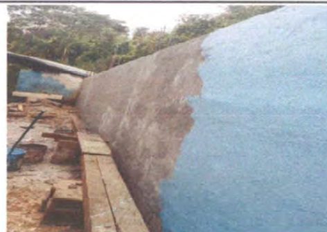
Foto 10: PINTURA EN MURO PERIMETRAL
