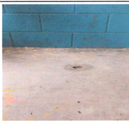
Foto 4: Grietas en las aulas
