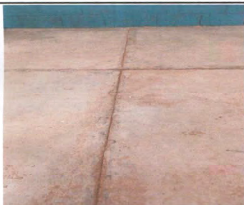
Foto 3: Grietas en las aulas
