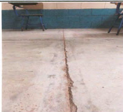
Foto 1: Grietas en las aulas
