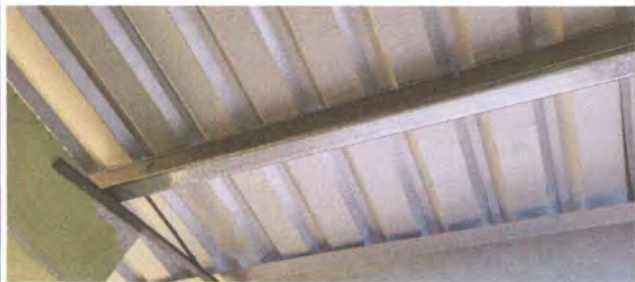
Foto 1: SUSTITUCION DE COSTANERAS EN MALESTADO
