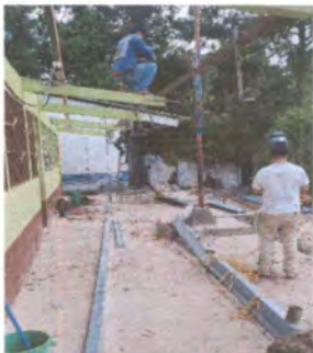
Foto1: SUSTITUCION DE COSTANERAS EN MALESTADO
