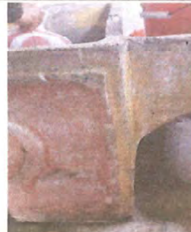
Foto 4: SUSTITUCION DE PILA EN MAL ESTADO EN COCINA
