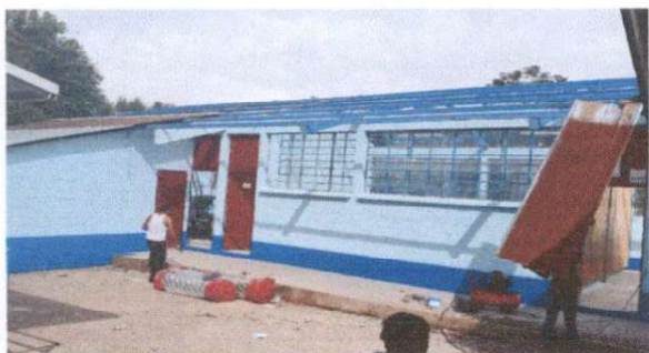
Foto 1: SUSTITUCIÓN DE LÁMINA EN MAL ESTADO
