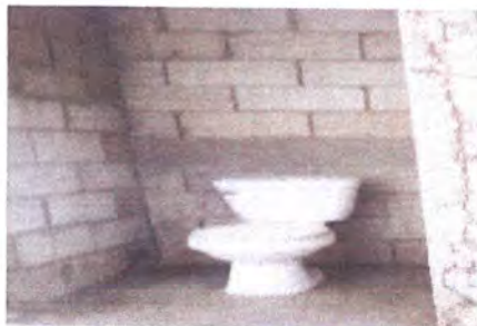
Foto 5: Servicios sanitarios y sus accesorios.
