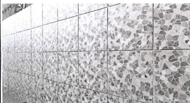
Foto 9: PISO DE CORREDOR
