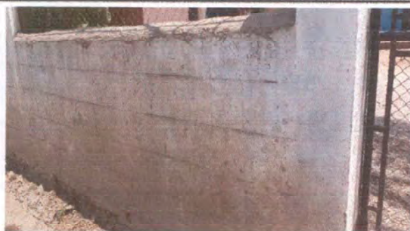
Foto 11: DAÑOS EN EL MURO PERIMETRAL EXTERIOR
