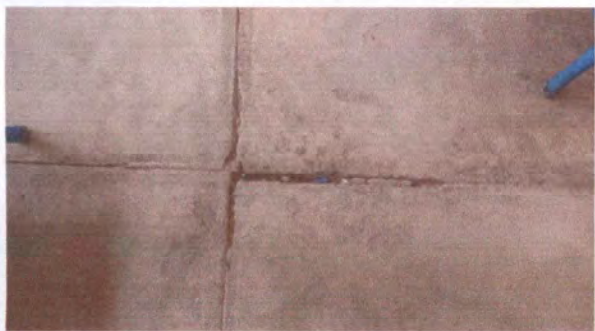
Foto 1: DAÑOS EN EL PISO DE LAS AULAS
