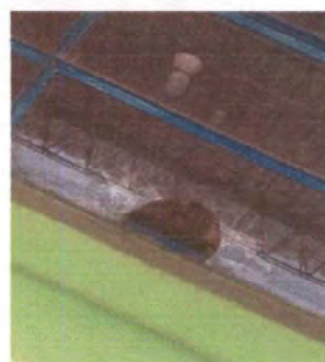
Foto 2: DAÑOS EN LOS VIDRIOS DE LAS VENTANAS
