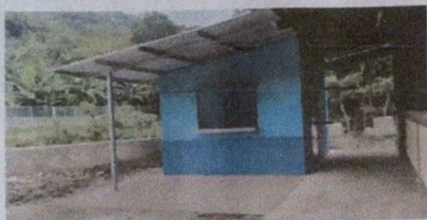
Foto 1: Sustrucción completa de paredes de cocina
