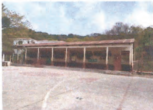
Vista de enfrente de escuela, balcones en mantenimiento.
