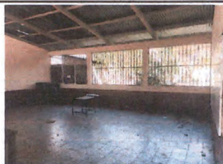
Piso de granito en mal estado
