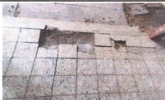
Piso de granito actualmente en mal estado
