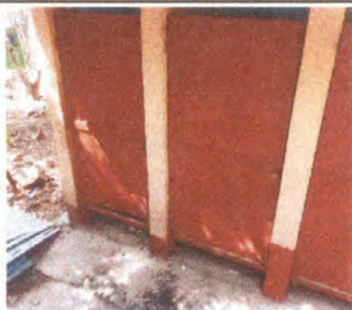
Área de baños a mejorar
