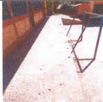
Área a mejorar con baranda metálica
