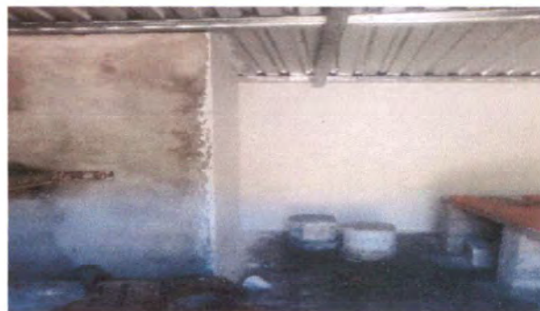
Foto 8: REPELLO EN PAREDES
