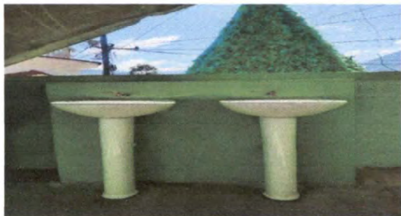
Foto 7: SUSTITUCIÓN DE LAVAMANOS, PORQUE SE ENCUENTRAN EN MAL ESTADO.
