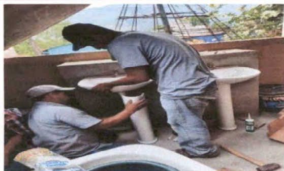
Foto 7: SUSTITUCIÓN DE LAVAMANOS, PORQUE SE ENCUENTRAN EN MAL ESTADO.
