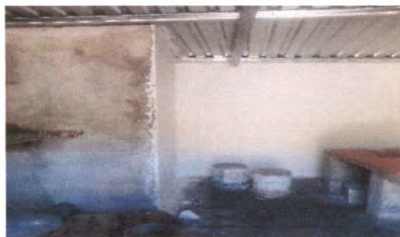
Foto 9: CERNIDO EN PAREDES
