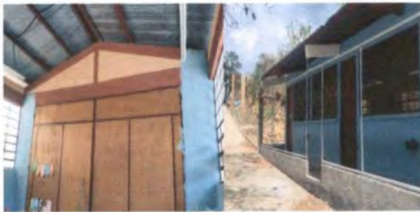
Foto 3: Pintura en exterior e interior pendiente
