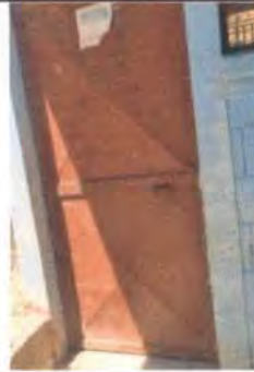
Foto 2: El mantenimiento a estructura de puertas se encuentra pendiente
