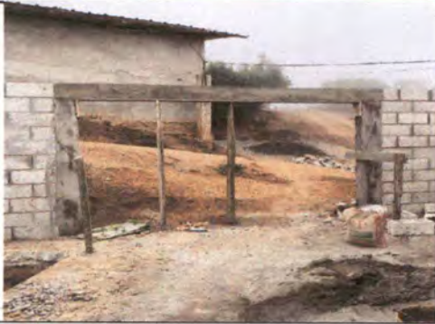
Foto 1: Sustrucción de portón de metal de ingreso al establecimiento
