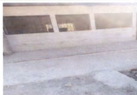
Foto 4: Los muros necesitan repello, cernido y pintura
