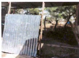
Foto 3: La puerta necesita ser sustituida
