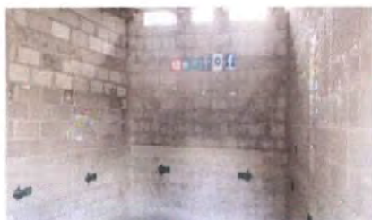
Foto 1: Las paredes del aula necesitan repello, cernido y pintura para tener un ambiente agradable
