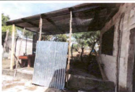
Foto 3: Los muros perimetrales necesitan ser reparados desde sus cimientos
