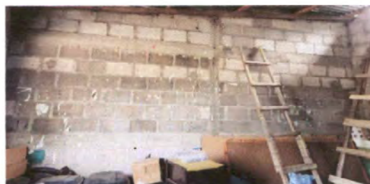
Foto 2: El muro perimetral necesita repello, cernido y pintura
