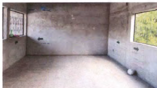
Foto 4: Los muros necesitan repello, cernido y pintura
