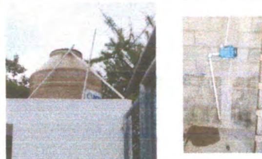
Foto 6: Depósito de agua y Bomba de agua
