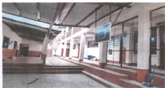
Foto 3: PISO EN MAL ESTADO
