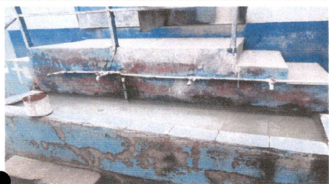
Foto 1: LAVAMANOS EN MAL ESTADO
