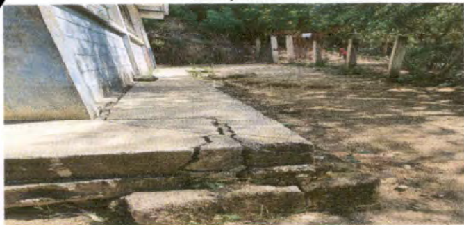
Foto 11: Banqueta de Concreto con necesidad de reparación.
