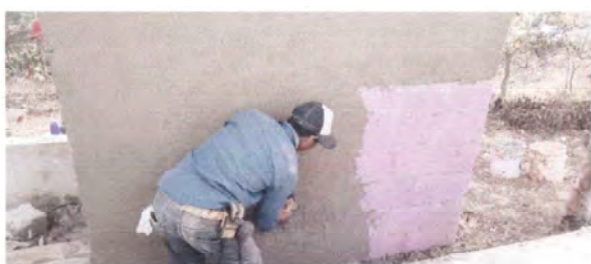
Foto 3: Cernido en sanitarios
