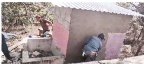
Foto 5: Cernido en sanitarios
