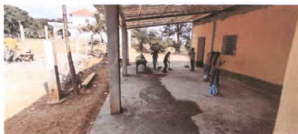
Foto 6: Torta de cemento fundida
