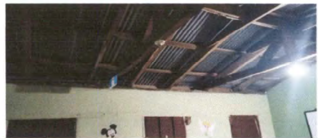
Foto 6: Madera y lámina en mal estado
