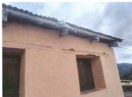
Foto 6: Madera y lámina en mal estado
