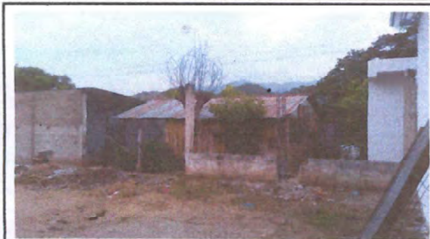
Foto 1: Muro desplomado luego de retirar árbol de min que se encontraba a la par del muro sección 1 del muro perimetral
