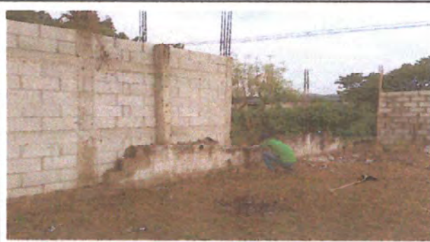
Foto 2: Verificación de estado de pared sección 3
